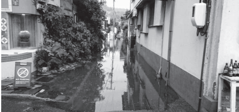
平成26年に冠水した宮ノ浦の道路
