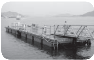
この桟橋補修して (本村港)
