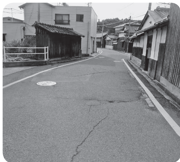
亀裂の入った道路
