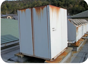
更新予定の空調設備
